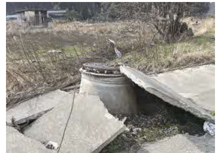
地盤の液状化により隆起したマンホール
