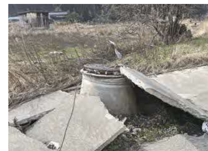
地盤の液状化により隆起したマンホール
