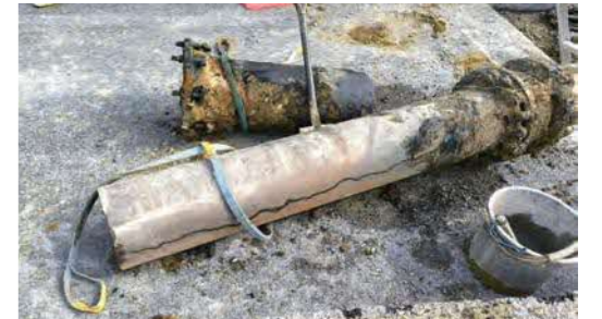
令和7年11月大和地区 布設から58年経過した水道管より漏水▶
