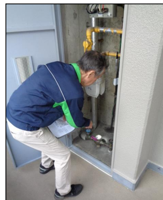
水道メーターを確認している様子
