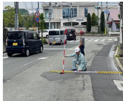
深さ0.3mの陥没状況(車道部)
