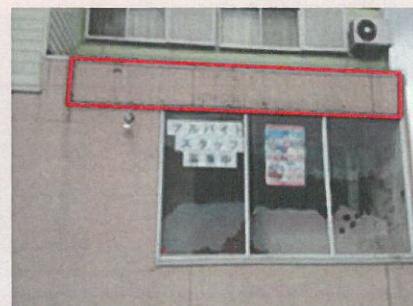
落下した後の壁面
