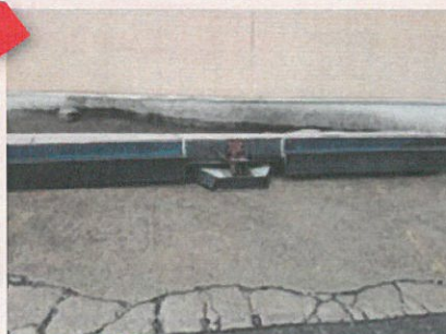
落下した欄間看板
