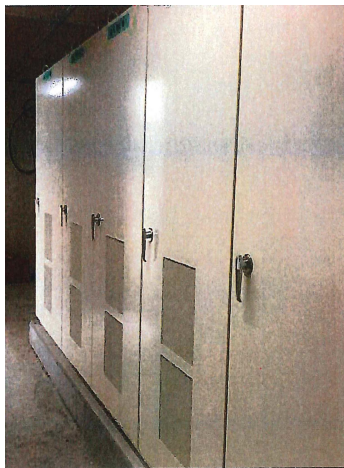
屋内に設置したキュービクル
