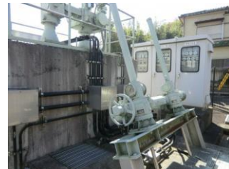
矢間 3 丁目 雨水ポンプ設備
