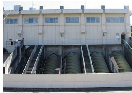
前川雨水ポンプ場 スクリューポンプ
