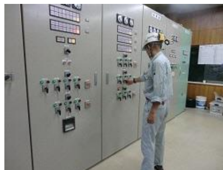
制御盤の操作
