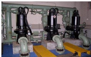
水明台汚水中継ポンプ場ポンプ施設
