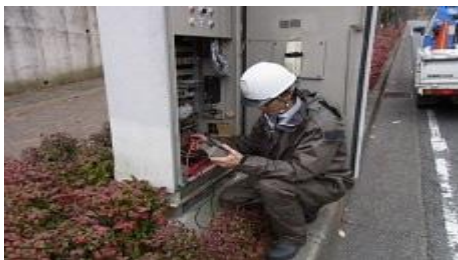
ポンプ制御盤の点検
