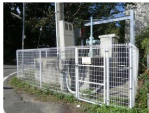
東多田雨水ポンプ設備
