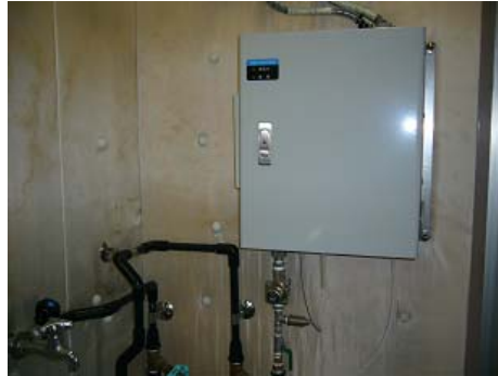
南部自動水質測定装置 (高芝水源地)
