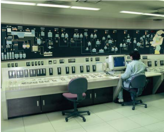
中央監視室 (久代浄水場)
