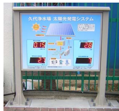
太陽光発電システム表示パネル
