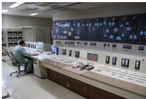
久代浄水場 中央監視室
