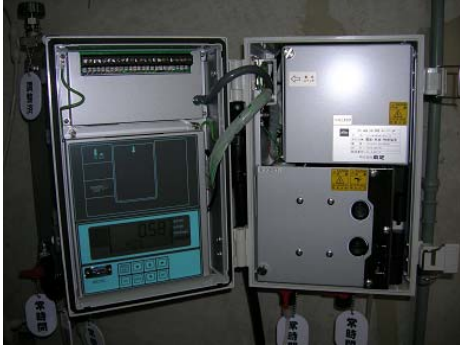
北部自動水質測定装置 (大和低区配水場)
