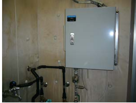
南部自動水質測定装置 (高芝水源地)
