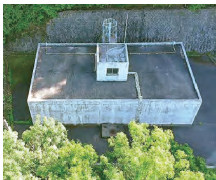
けやき坂高区配水池
