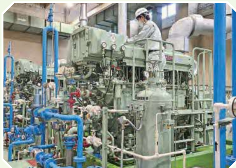
雨水ポンプの原動機点検
