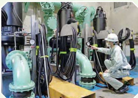
汚水ポンプの点検
