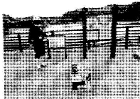
出合地区 設備点検作業
