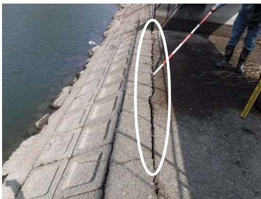
流入部 ひび割れ
