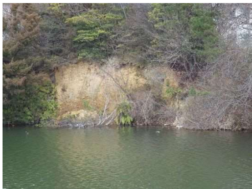
ため池周囲 土砂崩壊
