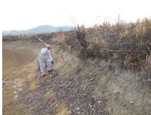
堤体の浸食状況
