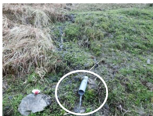
後法 漏水(遠景)
