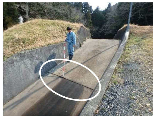
放水路部 漏水
