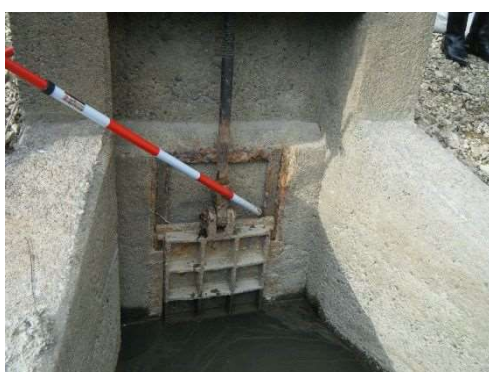
土砂吐ゲート部 腐食及びクラック
