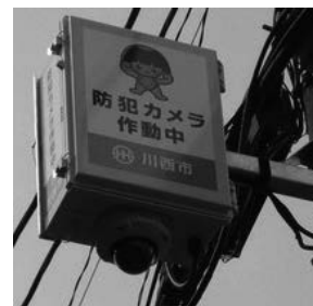
電柱に設置した防犯カメラ
