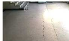
■ 床仕上げひび割れ状況
