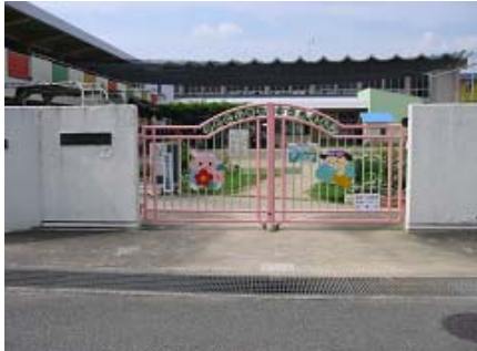
正門扉の修繕(開閉の不具合)
