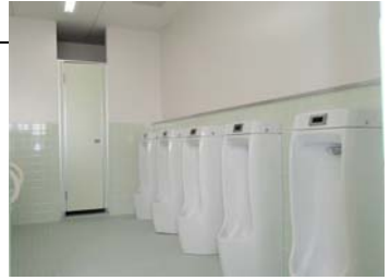
小便器はセンサー式を採用し、照明器具も人感センサー採用で、省エネ、節電効果を図った。(川西中学校南校舎棟男子トイレ)
