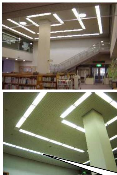
LED蛍光灯(1列8台)
