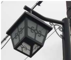
市道22号線街路灯(16基)
