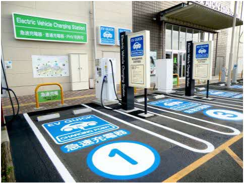
図 3-9 商業施設への充電器の整備
