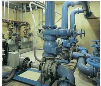
▲放流ポンプ室
