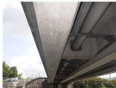
主桁にひびわれが見られます
