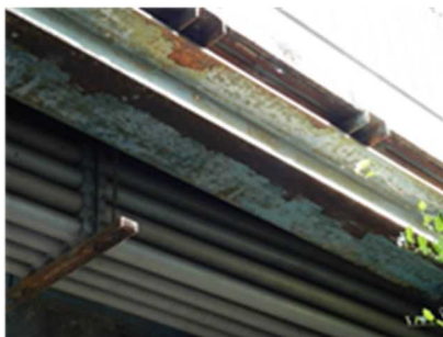
主桁に腐食が見られます
