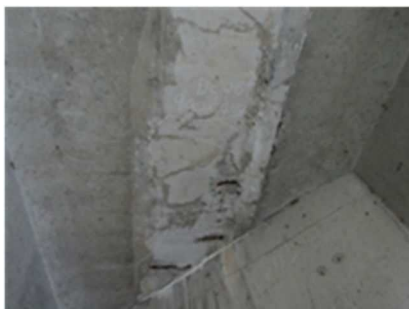
床版に剥離が見られます
