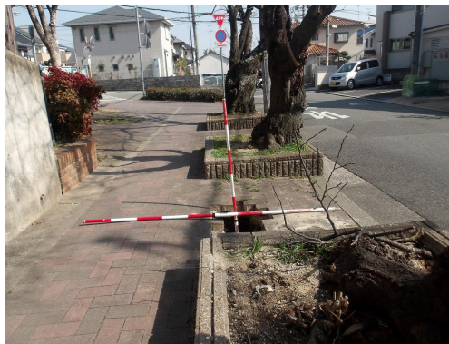
深さ1m陥没状況(歩道部)
