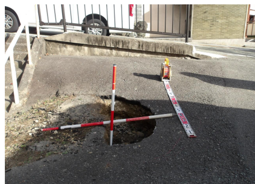
深さ1.5mの陥没状況(歩道部)
