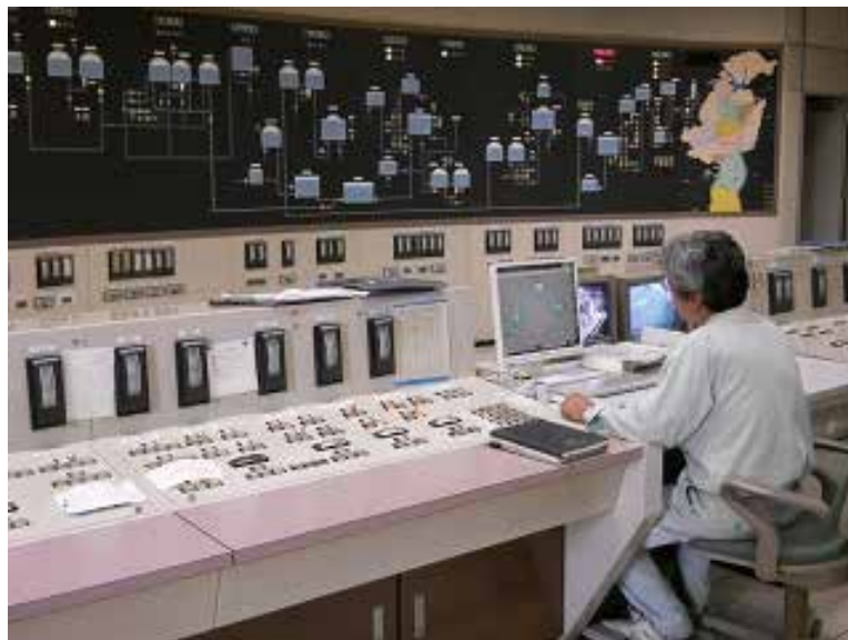
中央監視室 (久代浄水場)
