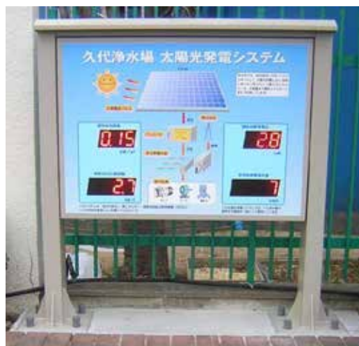
太陽光発電システム表示パネル
