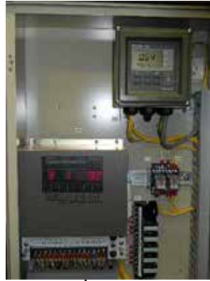
委託水系自動水質測定装置 (滝山配水池)
