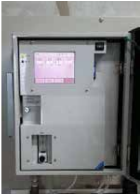
県水系自動水質測定装置 (大和低区配水場)
